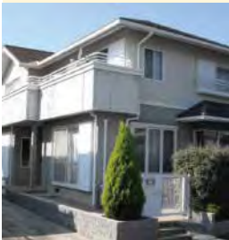
劣化して外壁も色あせてきます。
